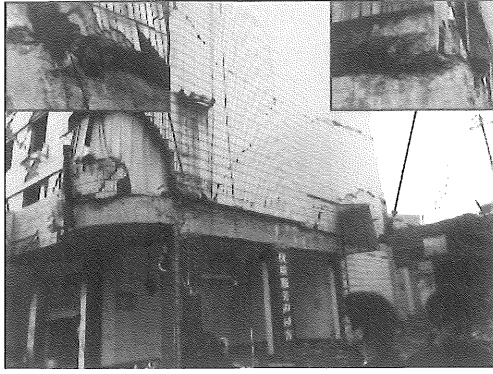
图 5 上部砌体结构整体水平侧移 Fig. 5 Horizontal displacement of the upper masonry stories
